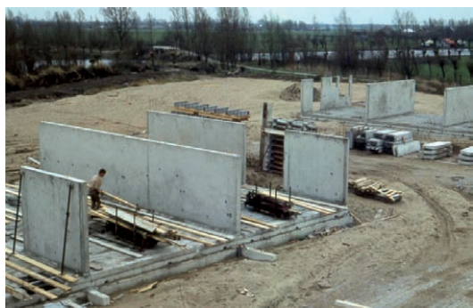
Op de voorgrond bouw van de gestapelde laagbouw en rechts-achter de bouw van de premiewoningen. Op de achtergrond het bruggetje richting de Goog.
