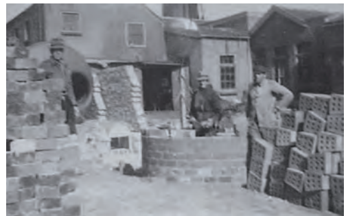
Schoorsteen in aanbouw bij wasserij 'Vecht en Dijk' van C. Hageman, het metselwerk wordt uitgevoerd door G. van der Voorn.
